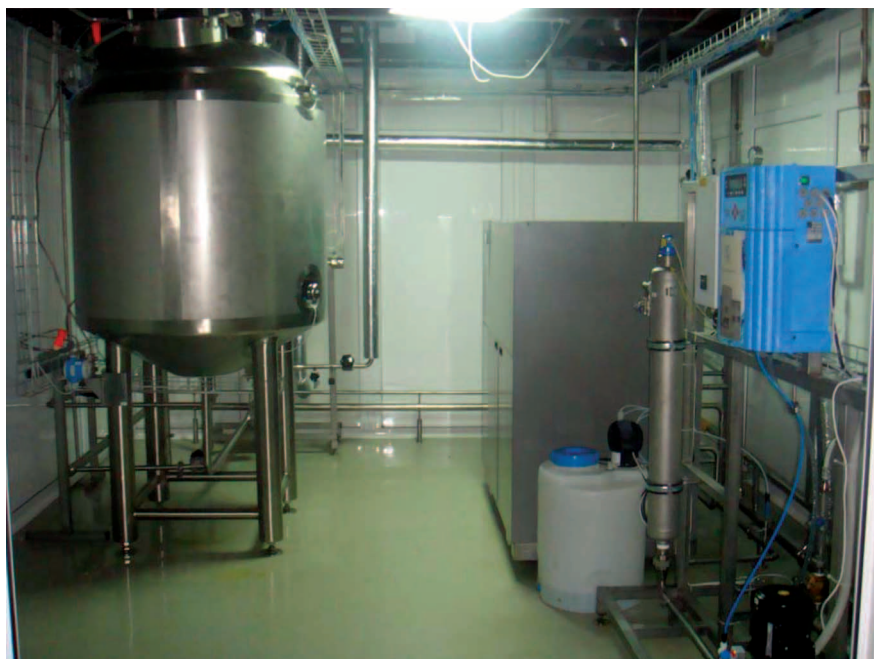
Рис. 6. Система приготовления, хранения и распределения воды для инъекций/воды высокоочищенной с использованием установки Septron line 30 HPW. ОАО Биохимик, Саранск
